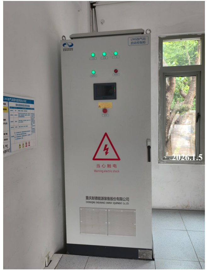
加气控制室控制柜
