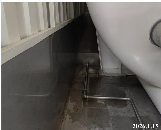
LNG 储罐围堰
