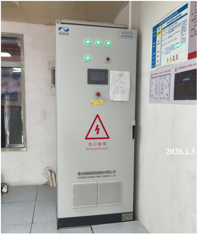
加气控制室控制柜
